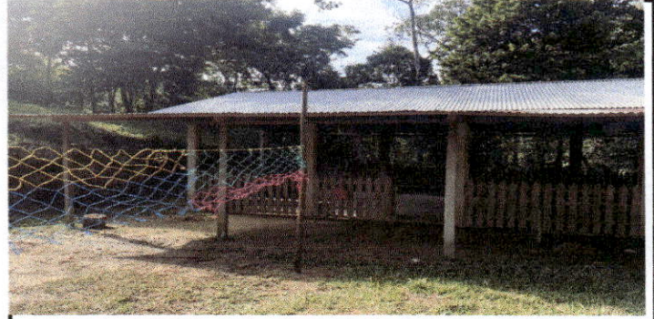
Foto 8: estructura en mal estado.
