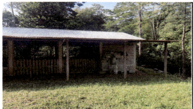
Foto 3: Piso con necesidad de aplicar torta de cemento.
