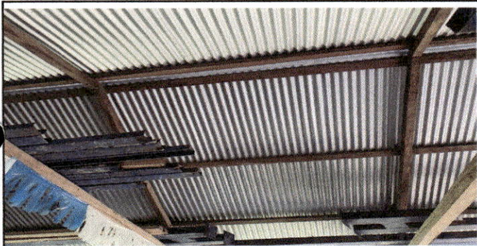
Foto 7: Estructura de madera no adecuada.
