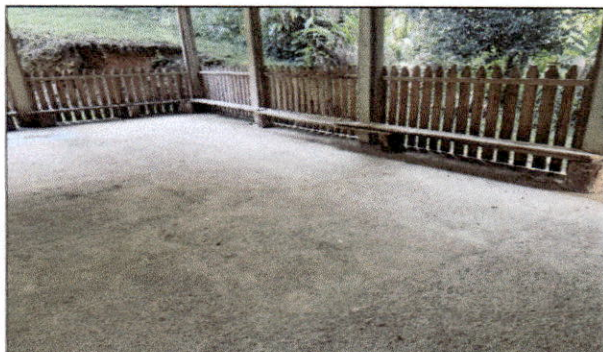
Foto 2: Piso del módulo 2 rajado.
