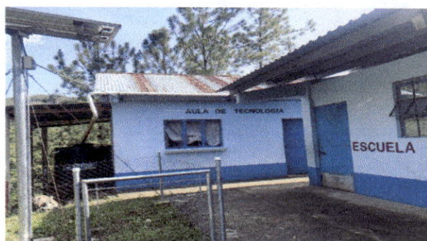
Foto 6: laminas en mal estado.
